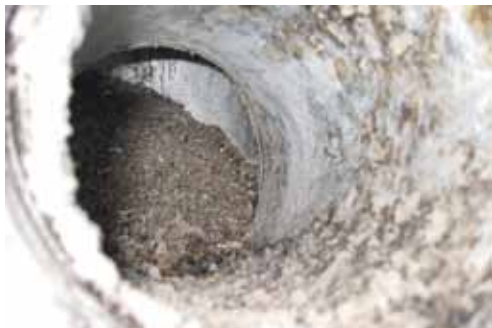
zanesená kondenzátní jímka a sopouch
